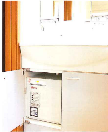
▲2階の洗面台には、真下に小型電気温水器が設置しており、蛇口をひねればすぐお湯が。
