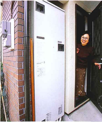
▲電気温水器設置を考慮した設計で、電気温水器は勝手口脇にすっきりと納められている。
